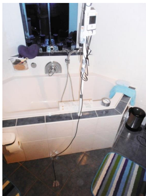
Foto 1.6 Plaatsing sensor vloertemperatuur
