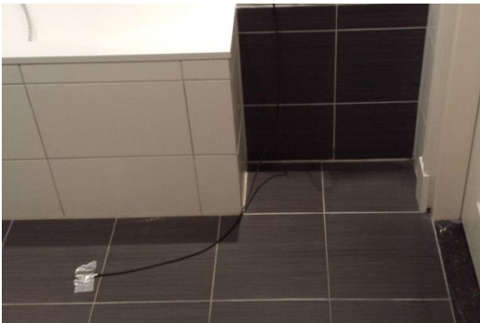
Foto 1.11 Plaatsing van de vloersensor.
