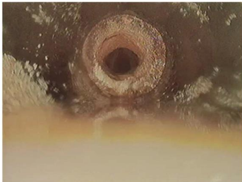
Figuur 4.52 Horizontaal deel direct bij inspectiepunt. Camera kon niet verder en de hoge druk spuit kon daar ook niet langs.
