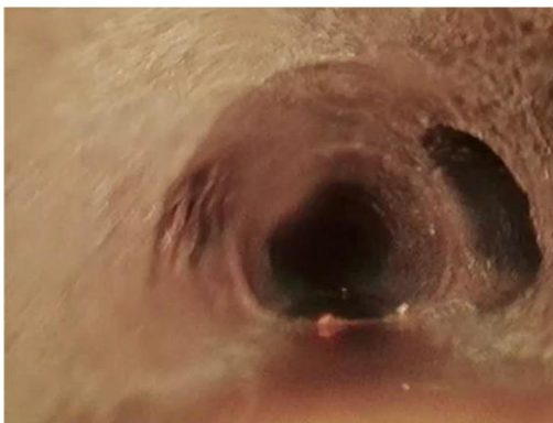
Beeld (van voor reiniging) met daarop de inprikkende leiding (rechts) van appartementencomplex 1 (op circa 5 m in leiding vanaf inspectiepunt)
