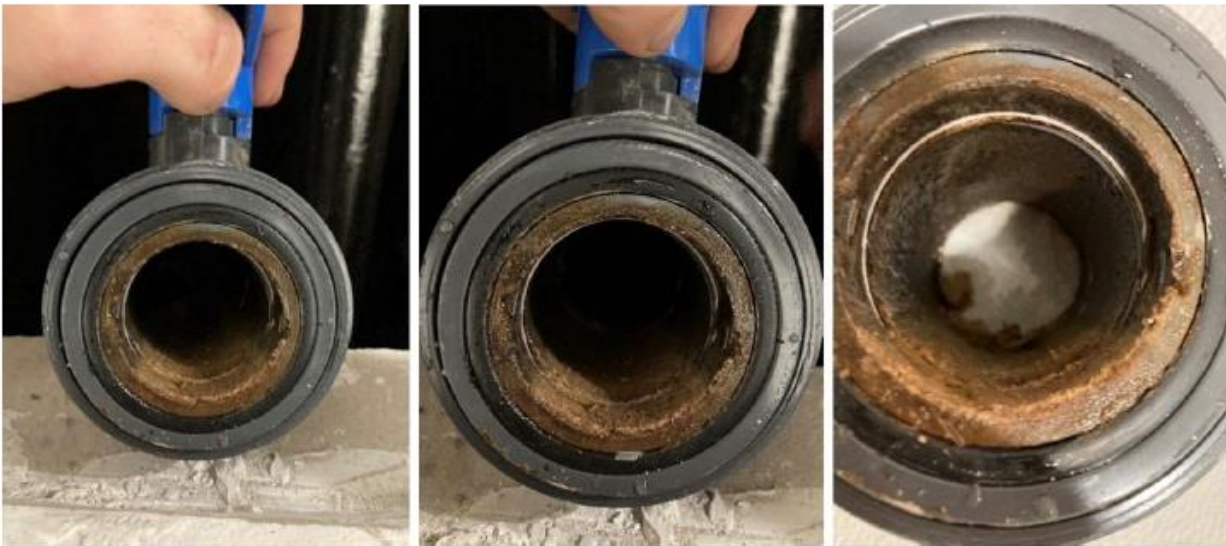
Figuur 3.1 Foto's van leiding bij huisaansluiting van een appartement in de wijk Nieuwe Dokken
