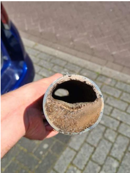
Figuur 3.1 Foto van uitgezaagd leidingdeel in horizontale leiding van rechtervleugel
